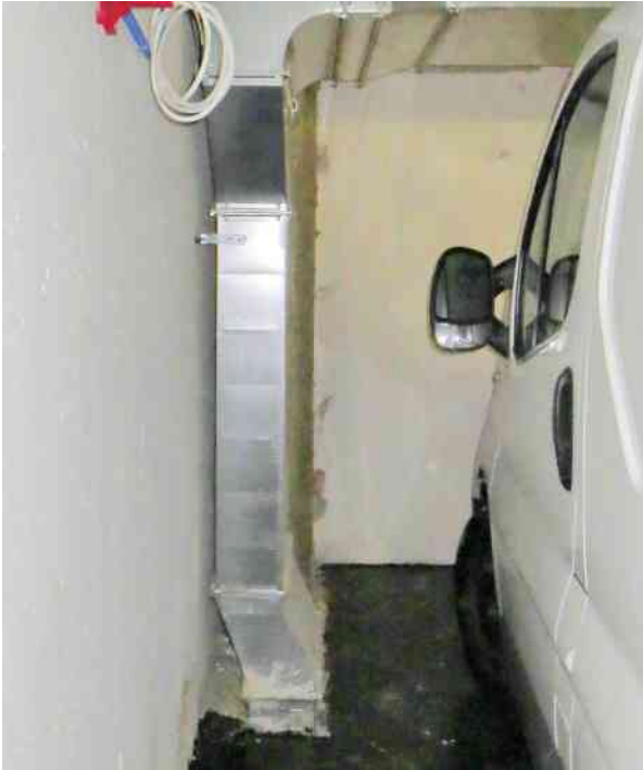
Wo ist die Dämmung? Kanal an die Wand gezogen (mit zwei unnötigen, teuren und aufwendigen Bögen), obwohl die Aussparung am richtigen Ort war. (Foto: Awel, Kt. Zürich)
